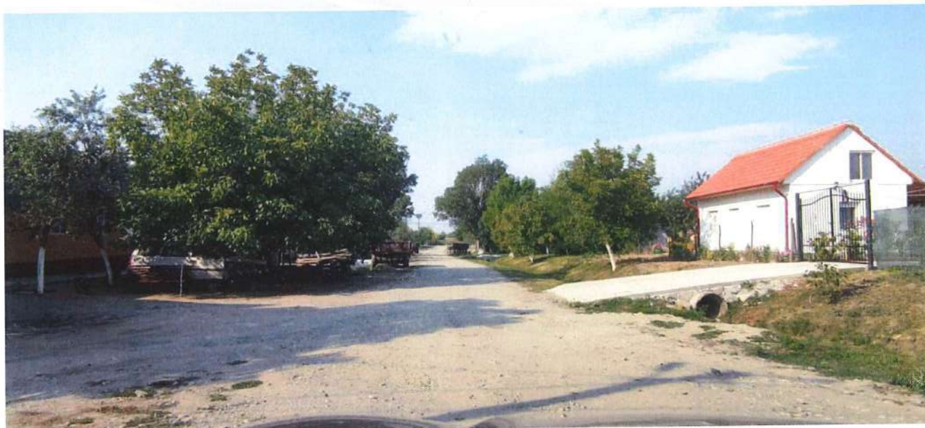
Foto 1. Zestre drum în stare bună, necesită scarificare și adaos din piatră spartă pentru planeitate
